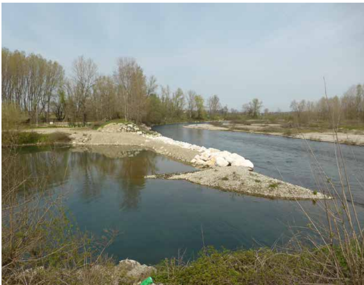
Figura 4.2: pennello spondale realizzato a protezione di una lanca, Parco Oglio Nord (comune di Soncino - CR)
