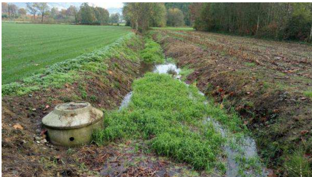
Figura 6: situazione ante operam canale che collega via Barzaghi con Torrente Boccogna con presenza di detriti e vegetazione
