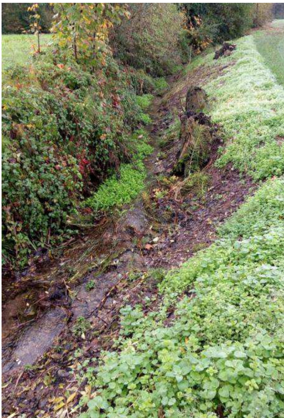
Figura 4: situazione ante operam canale che collega via Barzaghi con Torrente Boccogna con presenza di detriti
