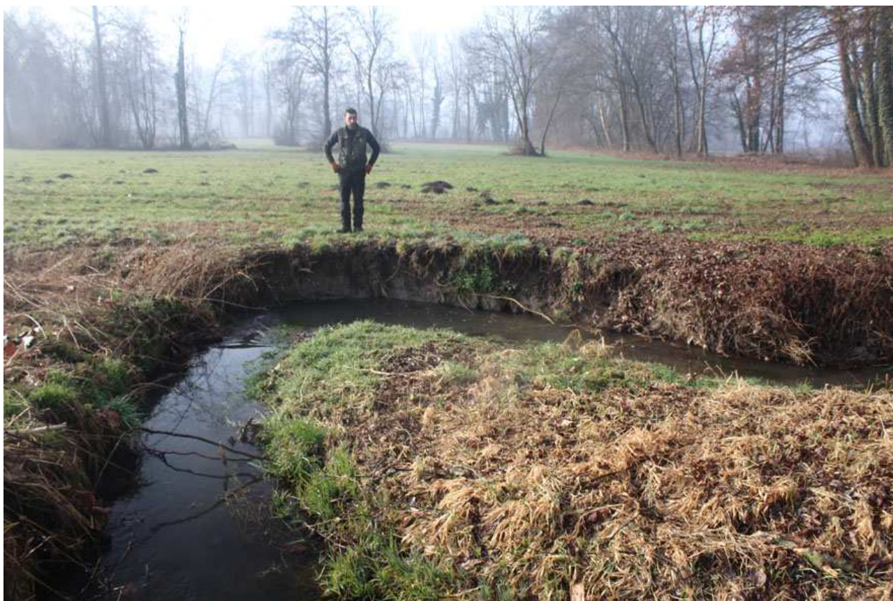
Sponda in forte erosione , lungo il tratto di corso d'acqua a valle della confluenza delle rogge Tre Ponti e Maneggio.
