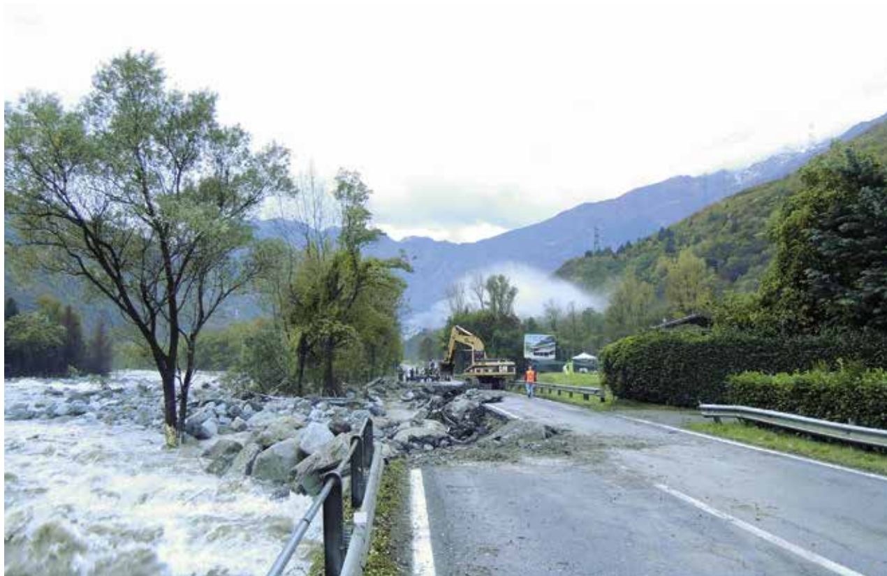
Figura 9 - Il 24 ottobre 2013 una piena del Fiume Oglio erose circa 70 m della SS42 fra Sonico e Malonno, in loc. Mollo, isolando l'alta valle (Foto Zaina G.).
