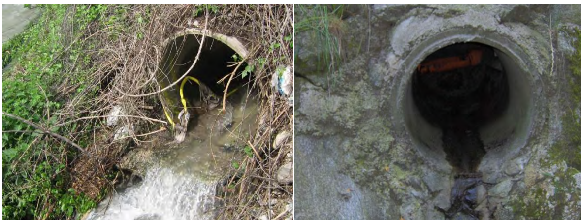
Figura 2.1.58. Scolmatore di Ponte Lambro (a sinistra) e di Caglio (a destra) attivi anche in tempo asciutto.
