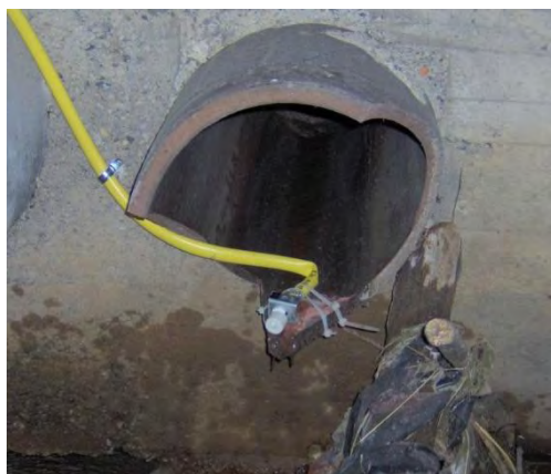
Figura 3.5. Dispositivo (livellostato) per la misura in continuo dell'attivazione dello scolmatore 1C7 di Eupilio (CO) (secondo la denominazione fornita dalla Provincia di Como).
