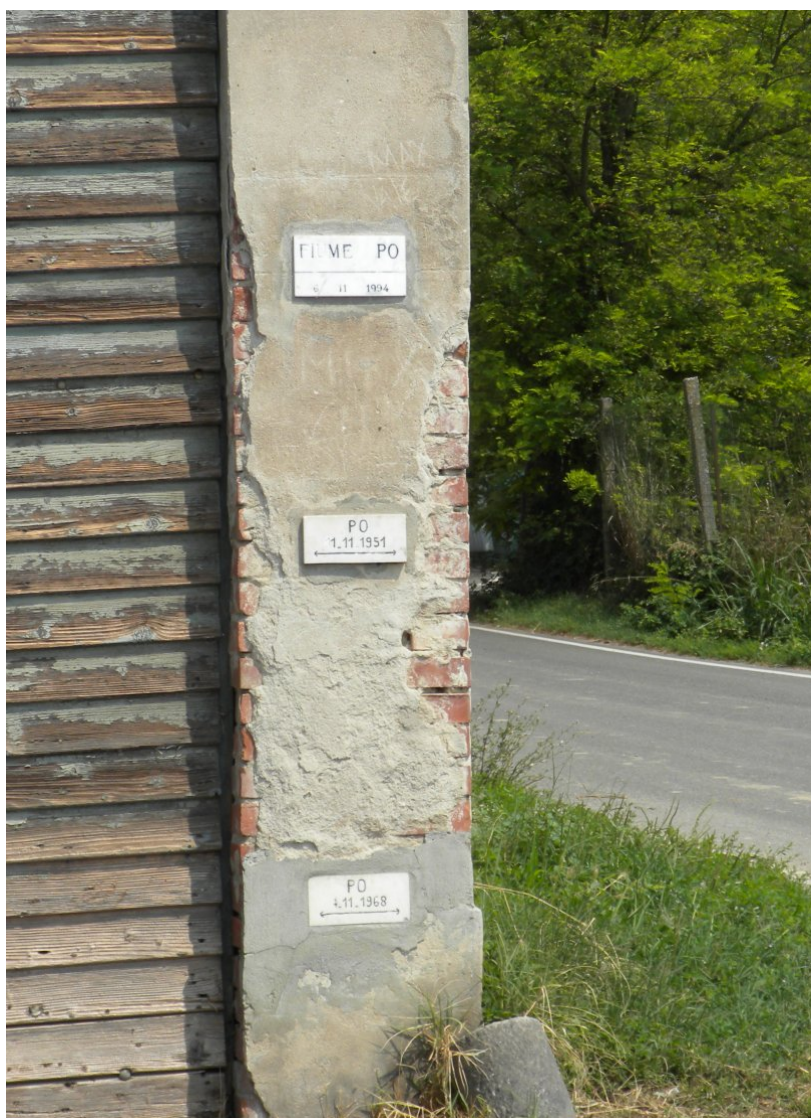
Figura 2.3 – Livelli delle piene storiche del Fiume Po nel comune di Arena Po.
