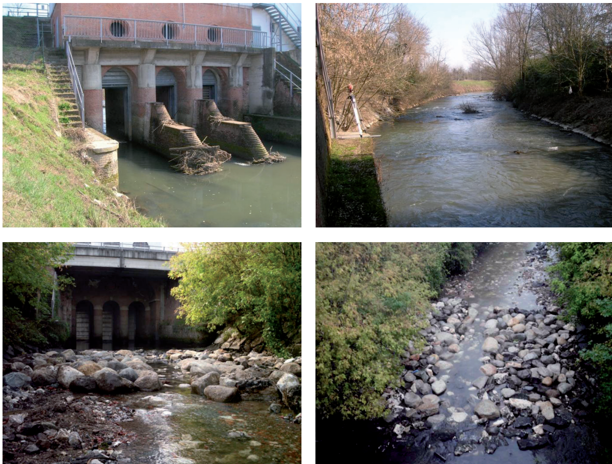
FIG. 8-3: INTERVENTO A VALLE DELLA CHIAVICA: ANTE OPERAM (SOPRA) E POST OPERAM (SOTTO).
