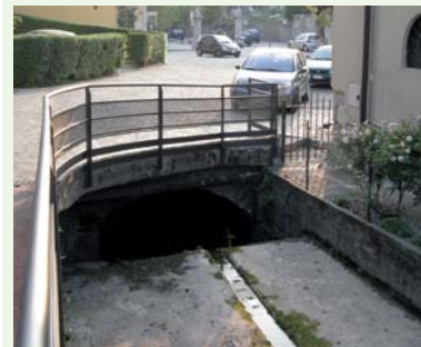
Tratti impercorribili dell'emissario: tratto intubato presso la Piazza XXV Aprile in località Corneno
