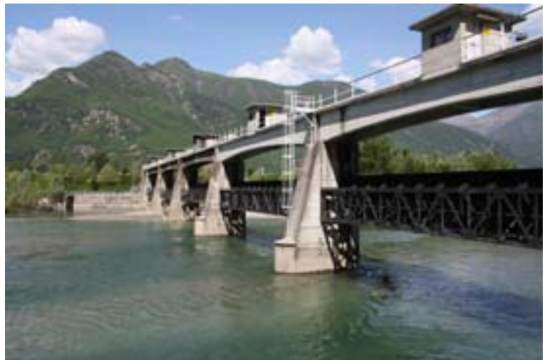
Particolare traversa Prata di Vogogna
