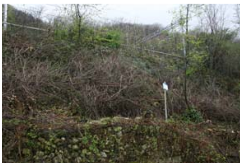
Recinzione metallica lungo la linea ferroviaria e scarpata degradante verso la spiaggia di Mergozzo
