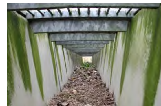
Sottopasso per la piccola fauna e particolare passaggio per anfibi (web)
