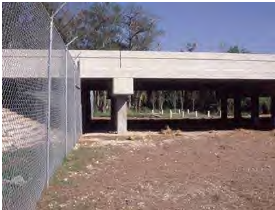
Barriera di invito al sottopasso faunistico e particolare dissuasori ottici (web)
