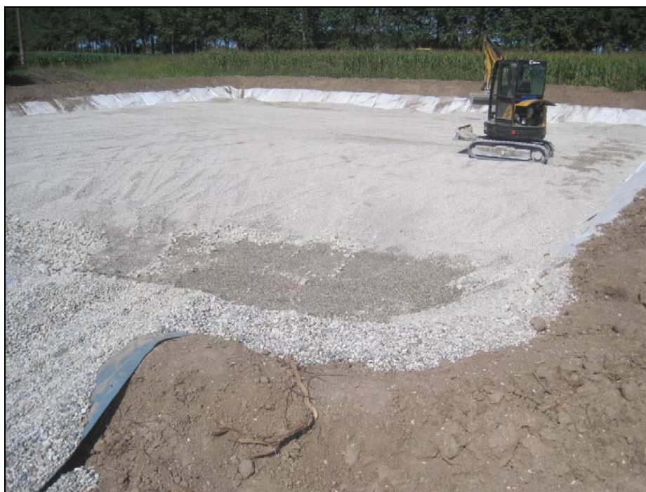
Figura 1 – L’impianto durante la fase di riempimento di uno dei due bacini con la ghiaia.
